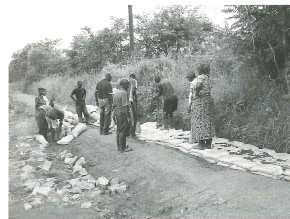
写真二 わだち部分に置かれた土のう（ザンビア）
